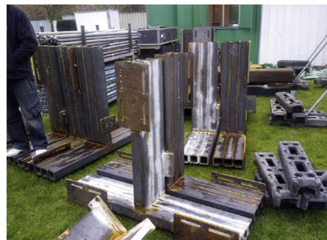
Stahlfüße für die Stützen
