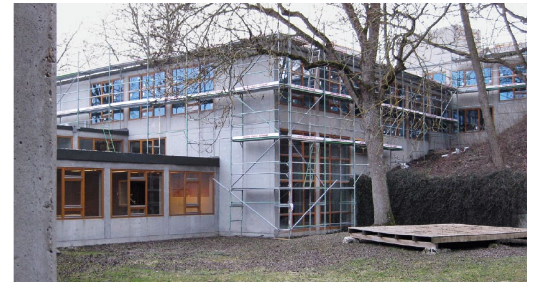
Wurden zum Sinnbild des Streits über den inhaltlichen wie baulichen Umgang mit dem Ulmer HfG-Erbe: die 2011 eingesetzten, blau getönten Sonnenschutzfenster. Foto: Benoît Girard
