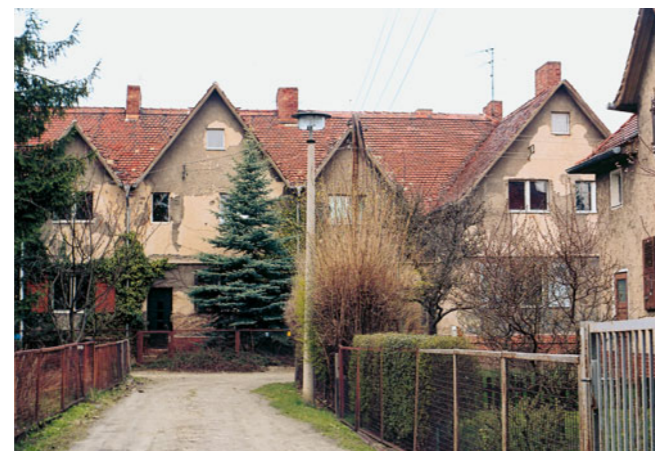
Zustand der Muthesius-Häuser in der Preußensiedlung nach drei Eigentümerwechseln und drei Sanierungskonzepten in neun Jahren. Foto: Matthias Grünzig
