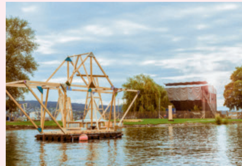
Bau und Installation des schwimmenden Pavillons Transfähre, der Teil des 40. Zürcher Theater Spektakels 2019 war. Fotos: Architecture for Refugees Schweiz
