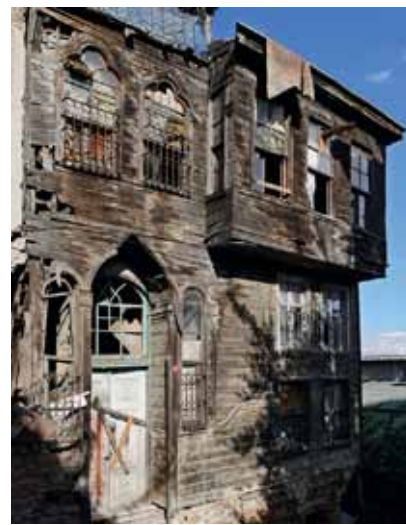
Der Backsteinbau des griechisch-orthodoxen Patriarchats thront über Balat, wo sanierte Häuser neben verfallenen osmanischen Holzhäusern stehen
