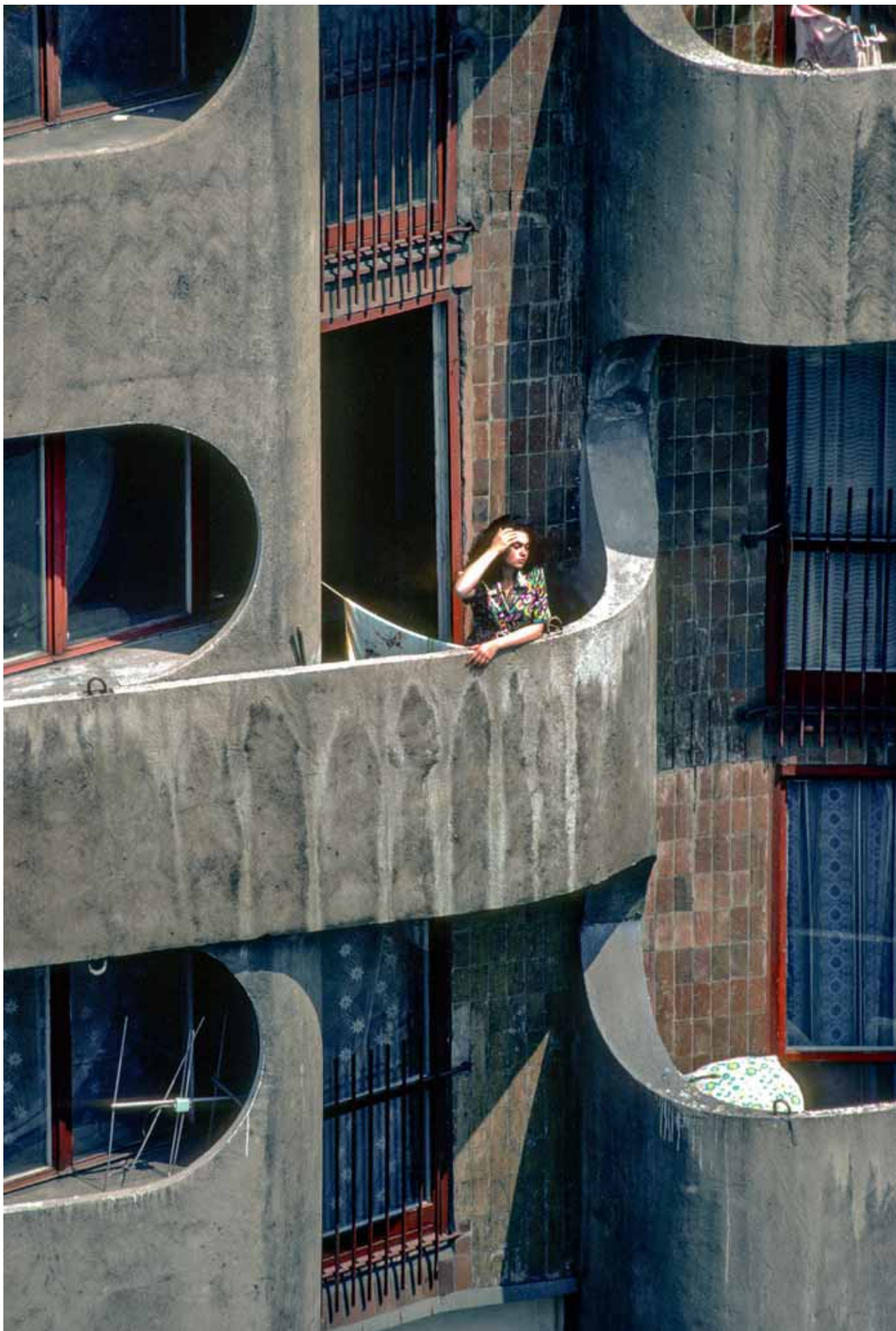
Manche nennen es Brutalismus – für die Stadt waren die Wohnhochhäuser am Plac Grunwaldzki, nach anfänglicher Gegenwehr, schließlich „futuristische Schmuckstücke“. Die Fassade nach mehrjähriger Bewitterung, davor eine anonyme Bewohnerin. Fotos: © Architekturmuseum Wrocław
