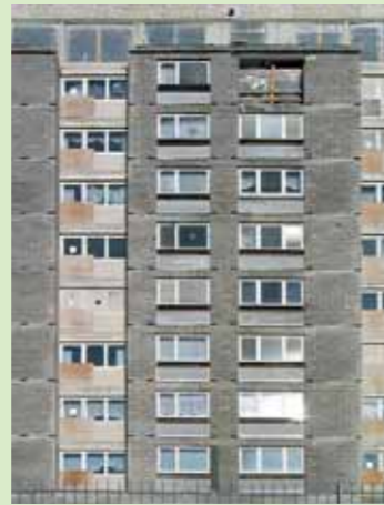
Während der Sanierung blieb das Gebäude fast vollständig von den Ursprungsmitiern bewohnt
