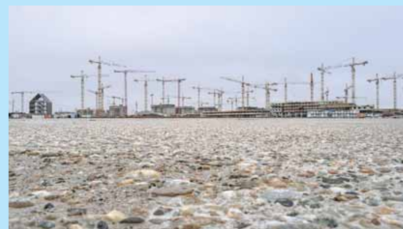
Ein Avatar der dichten europäischen Stadt in der Peripherie von Wien: Masterplan des schwedischen Büros Tovatt für die Seestadt Aspern auf einem ehemaligen Flughafen Foto: Michael Matzenberger
