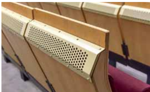
Die Stuhllehnen, jetzt mit neuen Verwirbelungsgittern (s. Zeichnung rechts). Die Luft wird aus einer unter dem Parkett angeordneten Druckkammer geblasen. Eine zweite, unter dem Rang geplante Druckkammer entpuppte sich als gar nicht ausgeführt.
